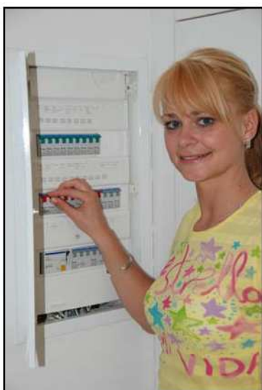
Obr.: Vypnutí hlavního jističe elektřiny
