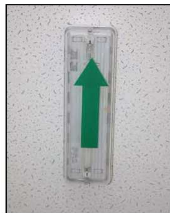
Obr.: Detail nouzového osvětlení
